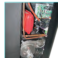
Ekspanzijska posuda, ventilator za odvod dimnih plinova
